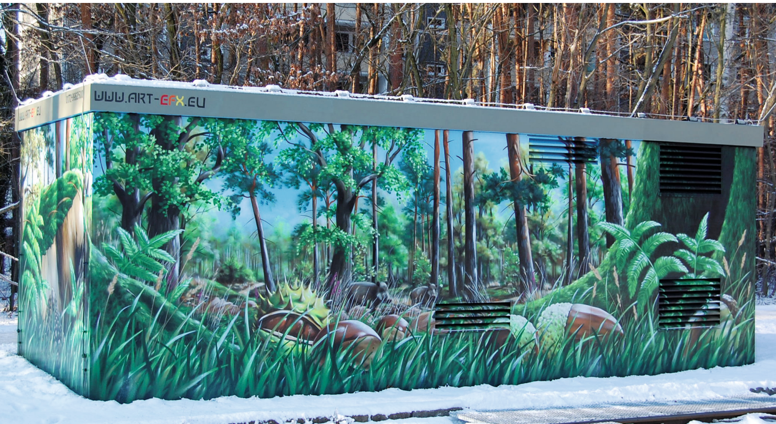
Unterwerk in fabrikgefertigten Beton-Fertigstationen – z. B. für ViP Potsdam (DC 750 V)
