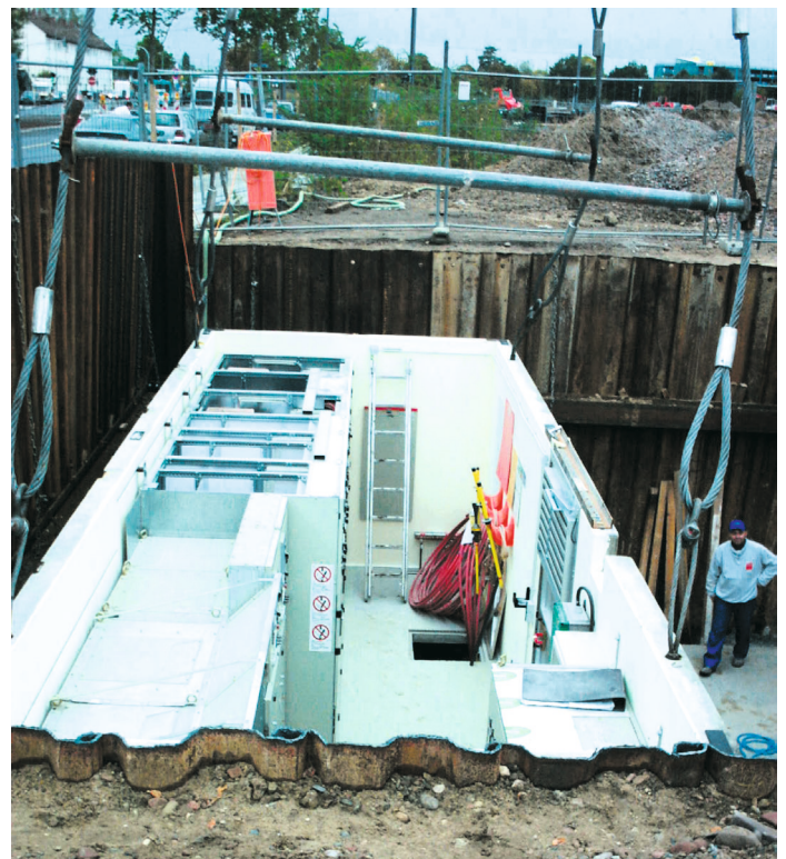
Spart Platz und ist unsichtbar: das Bahnstrom-Unterwerk im unterirdischen Betoncontainer
