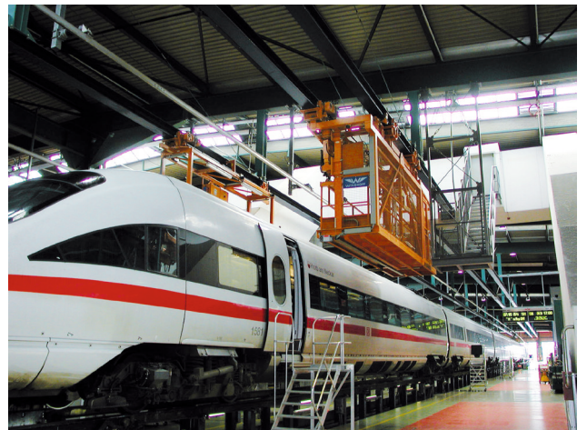
Werkstatt - hier ICE-Werk Frankfurt-Griesheim mit Mehrspannungsversorgungsanlage AC/DC
