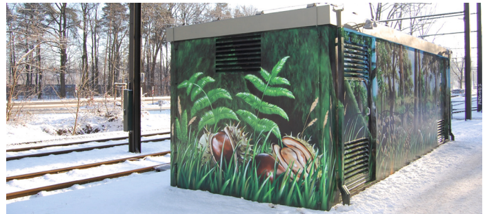
Container Unterwerk ViP Potsdam
