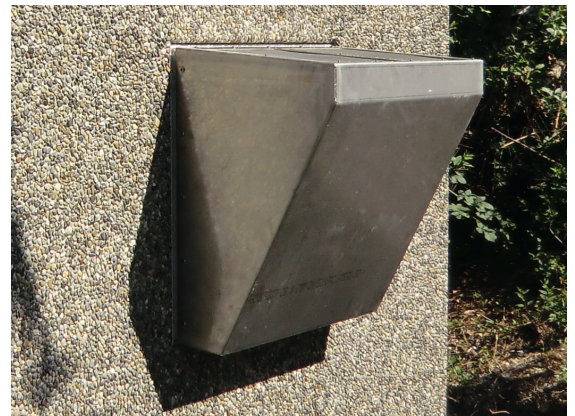
An der Gebäudeaußenseite montierte Druckentlastungshaube
