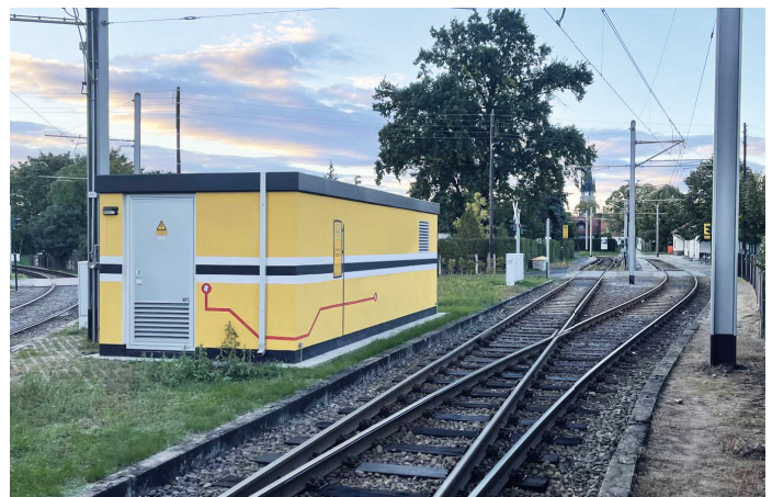
KGUW am finalen Aufstellungsort mit kurzen Kabelwegen in Wendeschleife platziert
