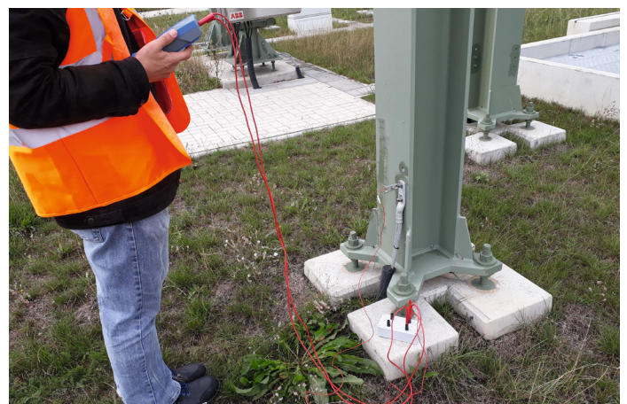
Messungen der Berührungsspannungen im dezentralen Umrichterwerk Schwerin
