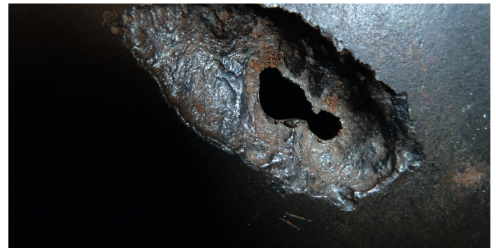
Schäden durch Streustromkorrosion an einer Rohrleitung
